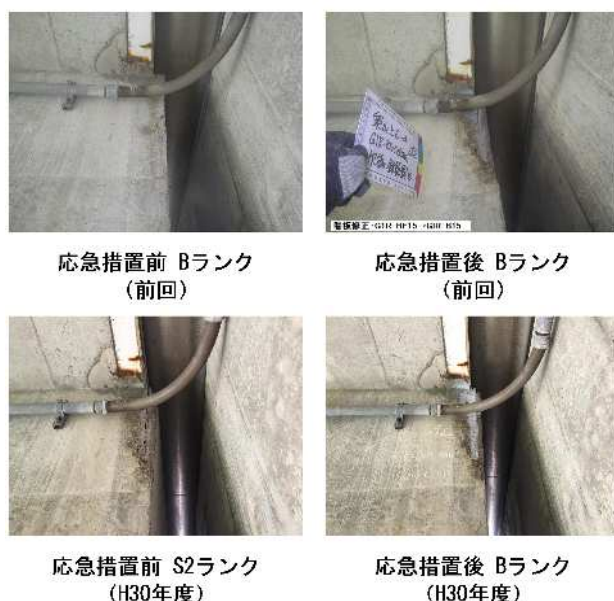
図-6 点検時応急措置を施した B ランク損傷の進展経緯
