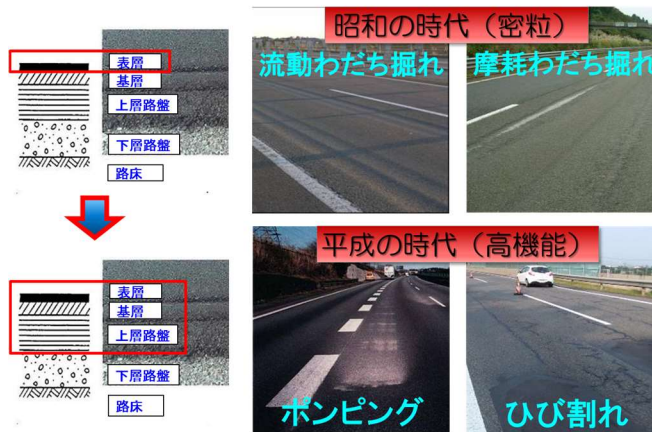
図-2 舗装損傷形態の変化
