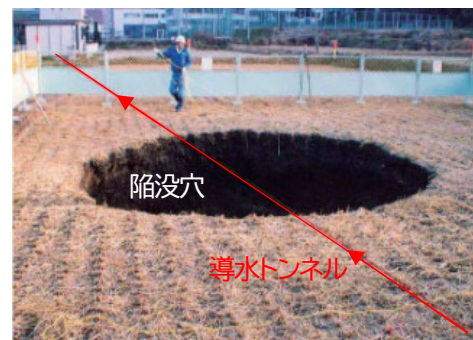
図-2 導水トンネル直上の陥没事例 2)
