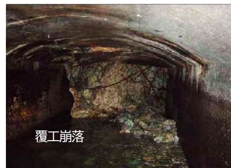
図-1 導水トンネルの崩落事例 1)
