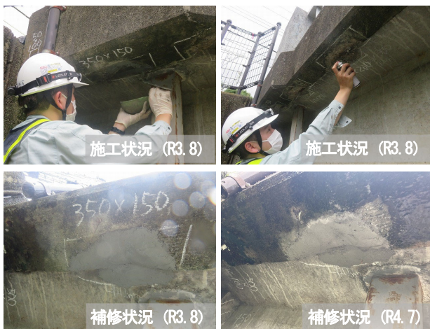
図-7 定期点検時の簡易補修
